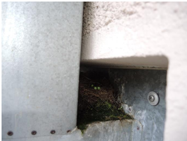
Vogelnest zwischen Wandfassade und Lüftungsschacht
