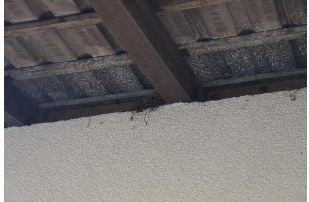
Vogelnest unterhalb des Dachstuhls „ehem. Betriebsgebäude“
